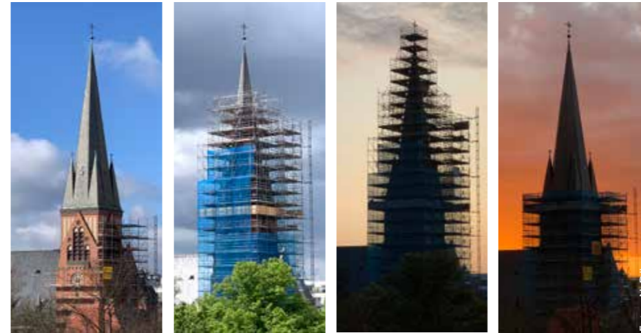
Verschiedene Stadien der Einrüstung des Auenkirchturms: Vom Aufbau des Gerüsts im Mai letzten Jahres bis zum Abbau am Beginn dieses Jahres
