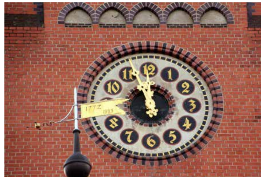
Die Uhr am Turm der Auenkirche werden wir während der Sanierungsarbeiten leider für eine Weile nicht sehen können.
